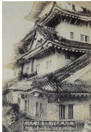
姫路城天守閣二層三層北側 損所ヲ乾天守ノ上層ヨリ見タル損所 (『姫路城修繕記念写真帖』姫路市立城内図書館蔵)
